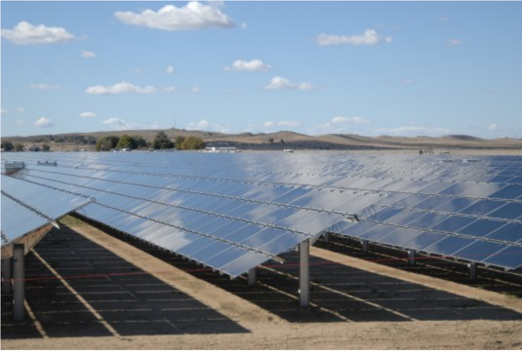
Abbildung 2: Fest montierte Solarmodule, Topaz Lake Solar Farm, eine der größten der Welt.
