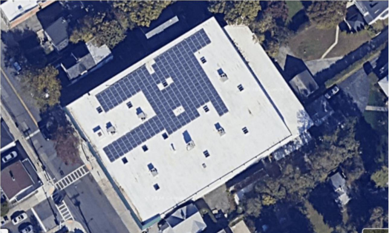
Abbildung 1: Ellenbogen-Fabrik mit einer 50-KW-Solaranlage auf dem Dach in New Rochelle, NY
