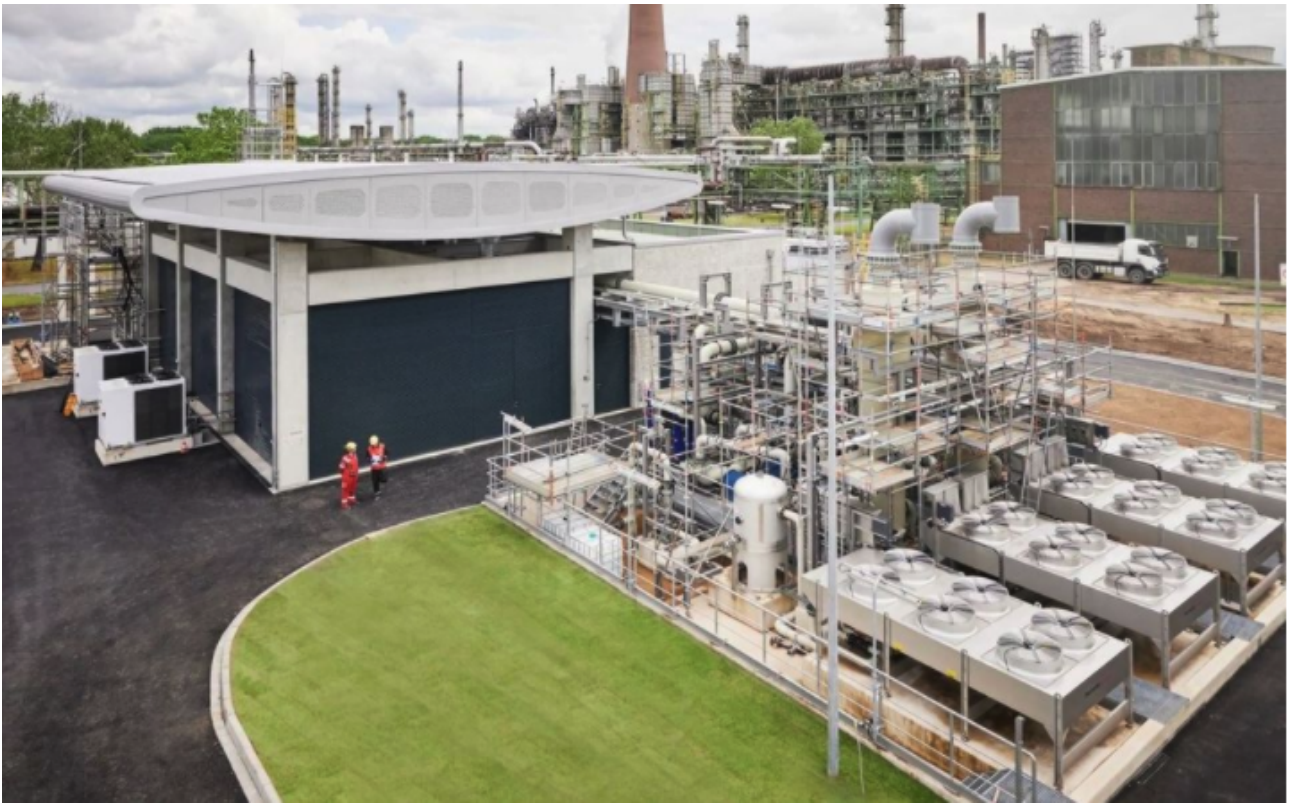
Bild 3. Elektrolyseur von Shell
