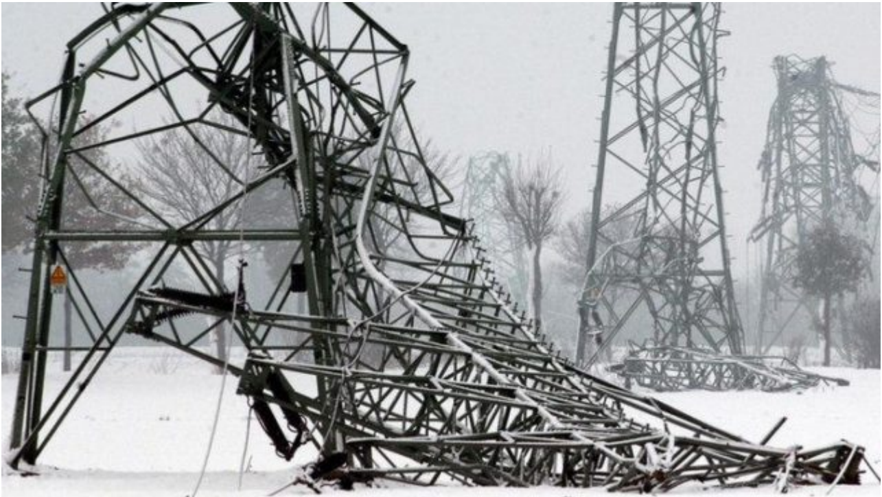
Bild 6: Typisches Schadensbild an den vom Eis überlasteten Hochspannungsmasten im Münsterland 2005 (Quelle. WDR)
