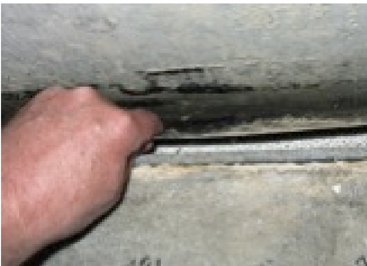
Schwarzer Schimmel auf Beton
