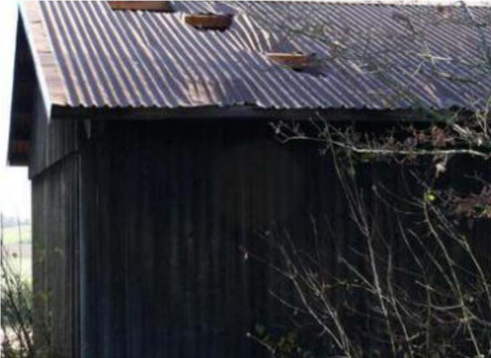
Bild 10: Eisgeschosse von einem 130 Meter entfernten Windrad haben drei Löcher in das Blechdach geschlagen. Ein Schädeldach wurde zum Glück nicht getroffen
