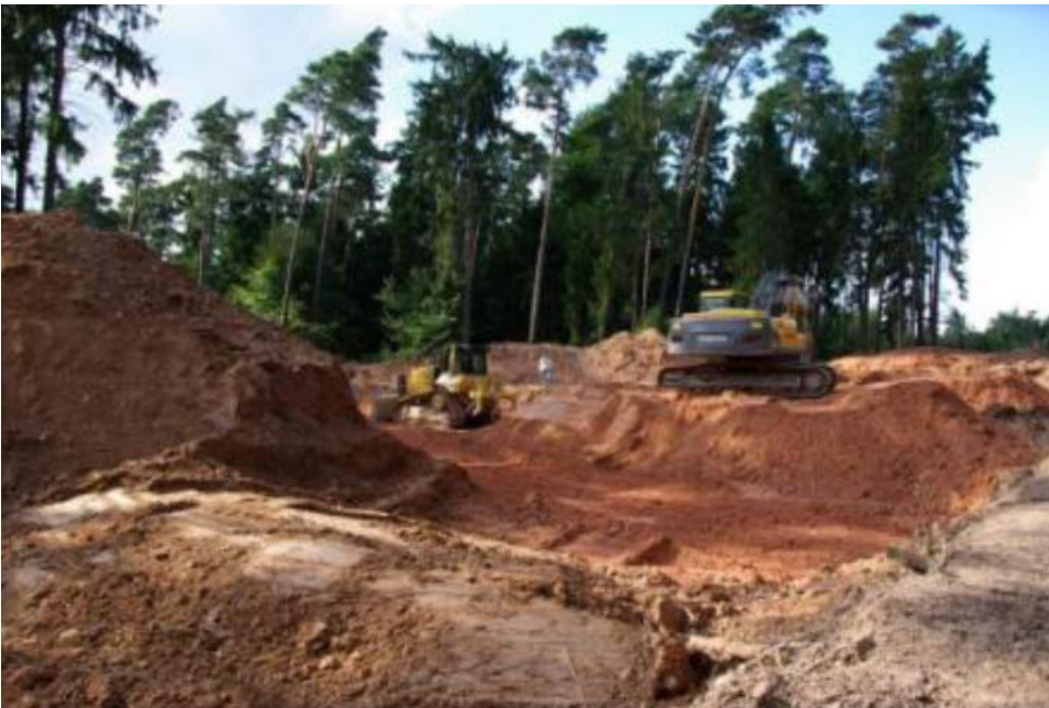
Bild 12: Für jedes Windrad werden 10.000 m 2 Wald zerstört und das Umfeld dauerhaft biologisch entwertet
